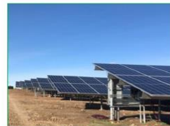
Kearsarge Ludlow (Ludlow, MA) – 5.0 MW
